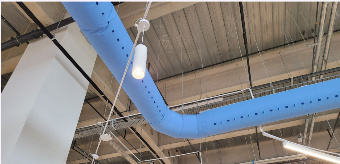
Figuur 8. Een textiele luchtverdeelslangen toegepast in een gebouw
